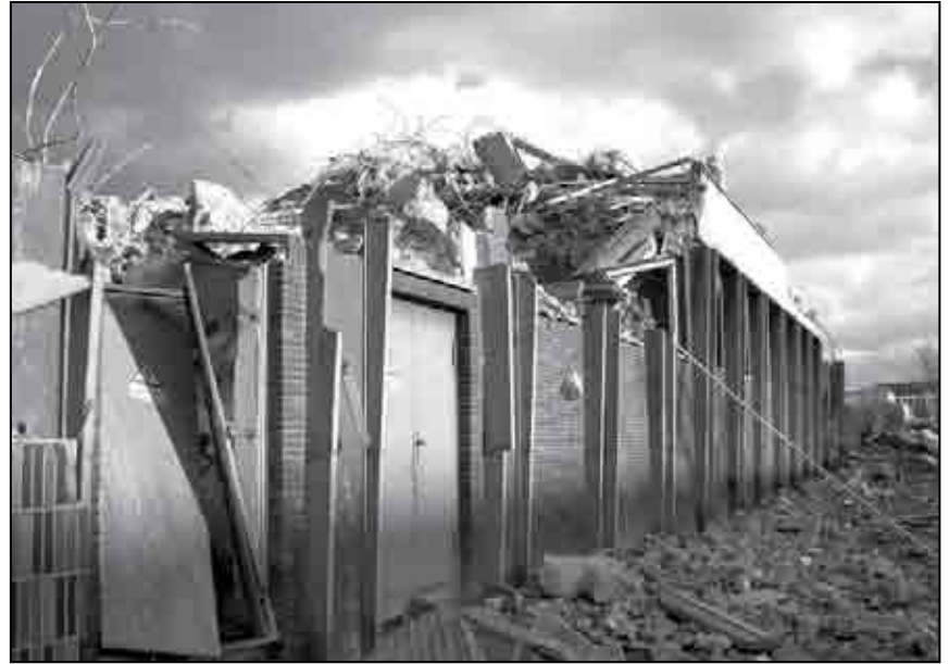
Die letzten Reste des ehemaligen Polizeidienstgebäudes.
